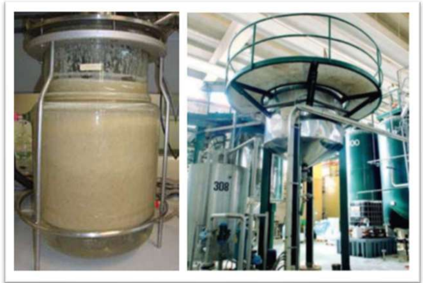
Impianto di idrolisi enzimatica presso ILSA
